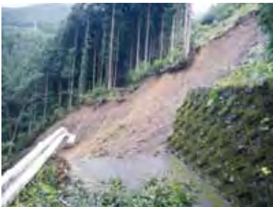
国道と沼田原地区を結ぶ村道が崩壊
